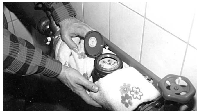
Bei Wintereinbruch müssen gefährdete Hausanschlüsse und Wasserzähler vor Frost geschützt werden.
