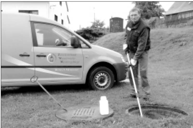
Gabriel Opp, Spezialfachmann für Kleinkläranlagen des ZWW bei der Wartung einer Tropfkörperanlage.
