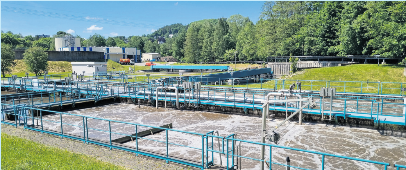
Energieoptimierung der Gebläsestation in der ZKA Schwarzenberg.
